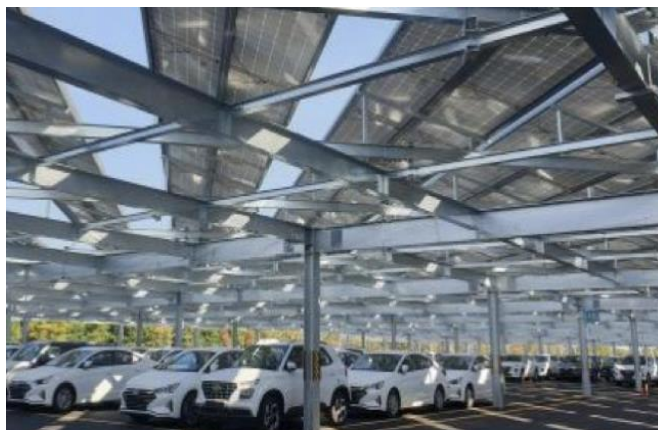
图表3-4 韩国蔚山工厂露天停车场的太阳能发电设施
